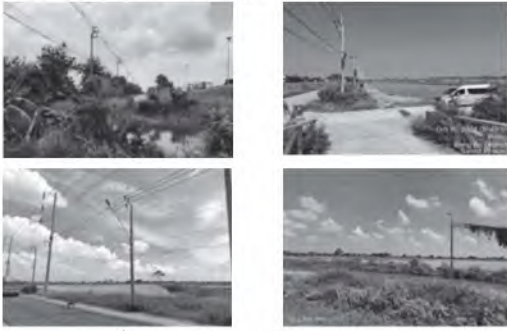
รูปที่ 5-15 ระบบไฟฟ้าของการไฟฟ้าส่วนภูมิภาค บริเวณข้างทาง
